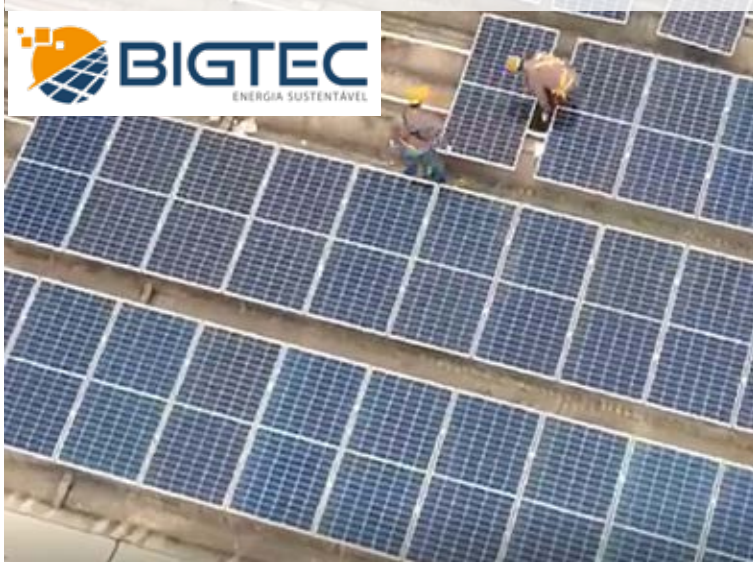
Big Tec: Usina de Energia Fotovoltaica em condomínios logísticos
